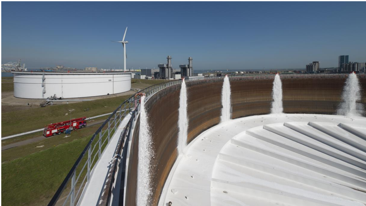
Inzet bedrijfsbrandweer bij het testen van een semi-stationaire rimseal blusvoorziening, BP Raffinaderij Rotterdam (Europoort)
