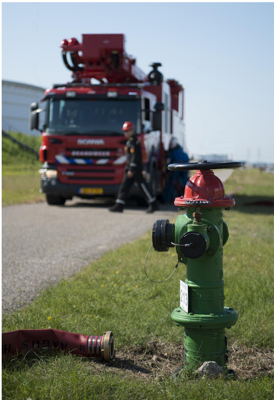
Hydrant 213 op het terrein van BP Raffinaderij Rotterdam (Europoort)
