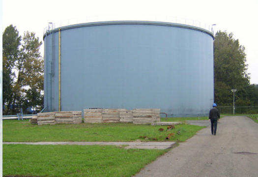
Opslagtank voor ethanol
