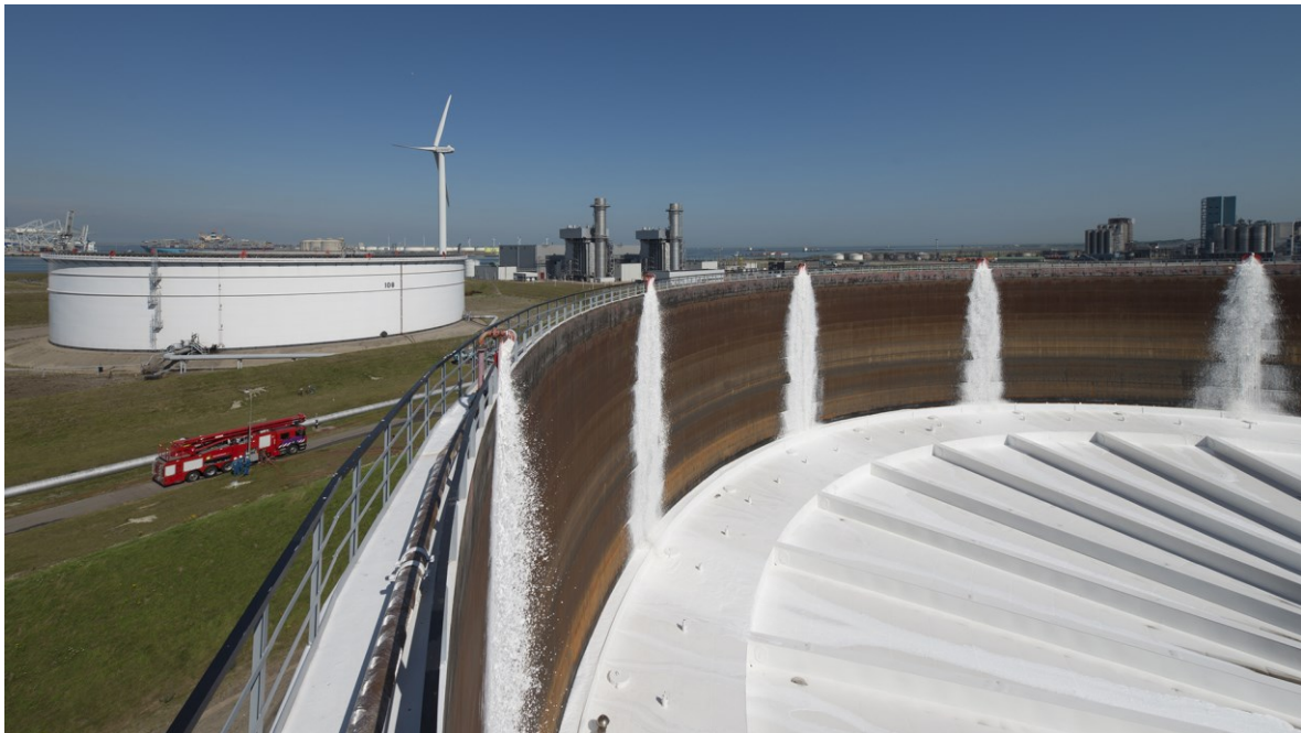
Inzet bedrijfsbrandweer bij het testen van een semi-stationaire rimseal blusvoorziening, BP Raffinaderij Rotterdam (Europoort)
