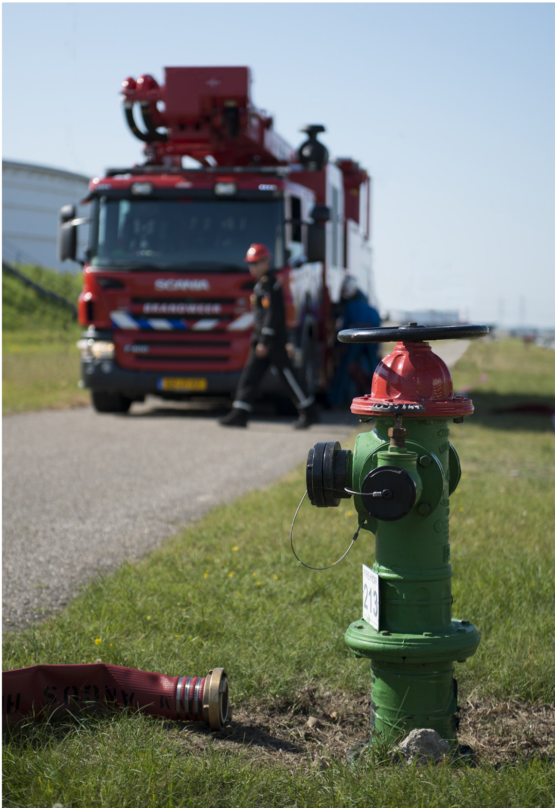
Hydrant 213 op het terrein van BP Raffinaderij Rotterdam (Europoort)
