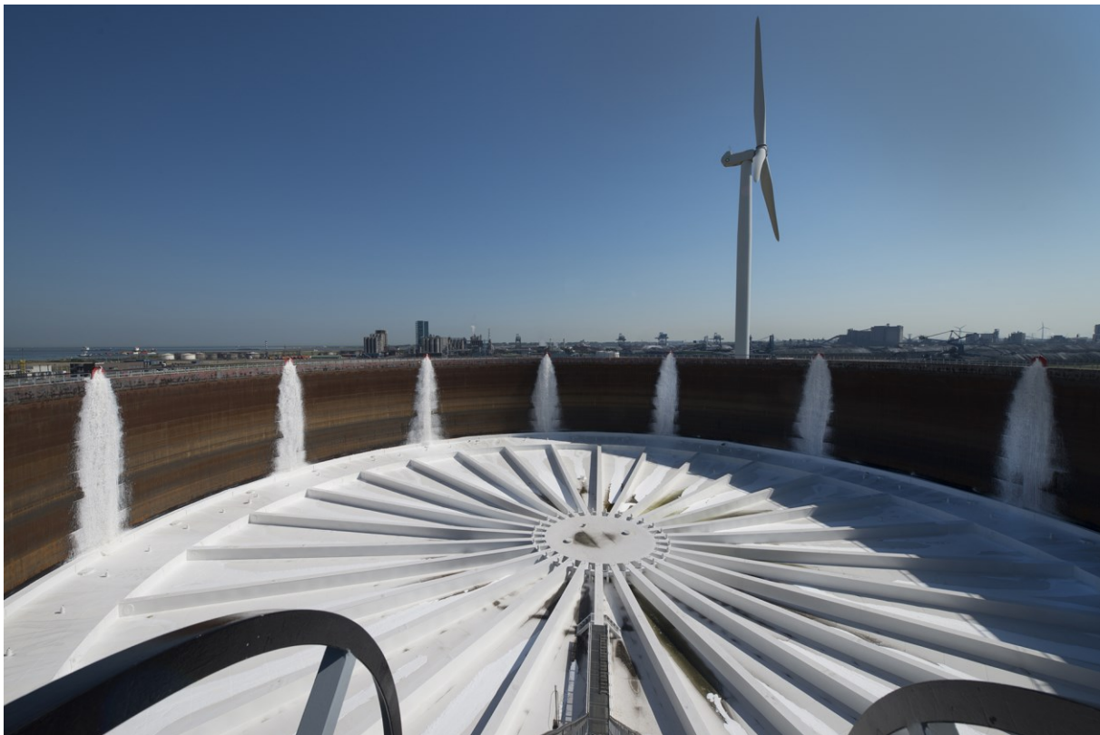
Live test van een rimseal schuimblusvoorziening, BP Raffinaderij Rotterdam (Europoort)
